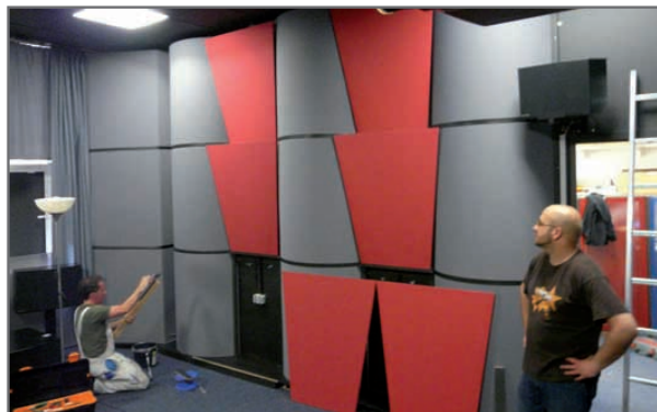
Die roten, trapezförmigen Elemente zwischen allen „Polys“ bestehen aus MDF-Platten und dienen der Zerstreung der Schallanteile in vertikaler Ebene. Daher sind diese Elemente in einem leicht geneigten Winkel angebracht und machen so aus den glatten Wänden eine diffuse Oberfläche. Bringt viel akustischen Effekt und sieht dazu auch noch gut aus.
